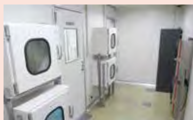
前室2/パスボックス
