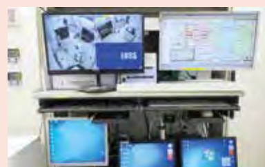
事務室 モニタリングシステム
